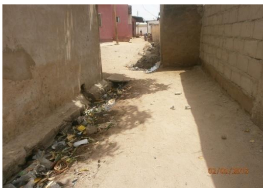
Photo 27 : évacuation des EU et EV en pleine rue à Boula Ibbéré
