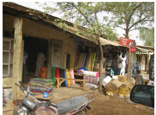
Photo 21 : Etat délabré des boutiques
