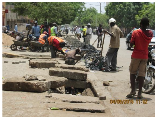
Photo 34 : ... nécessitant une intervention lourde pour les curer
