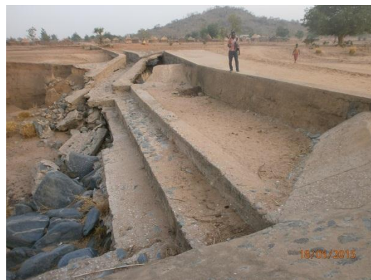
Photo 26 : Ouvrage de drainage menacé par l'effondrement
