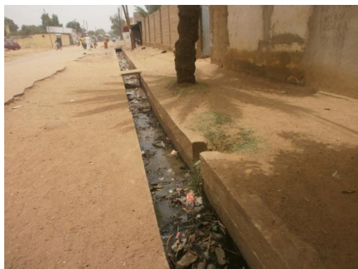
Photo 33 : les déchets obstruent les canaux même au niveau des artères principales (Bibémiré 2)
