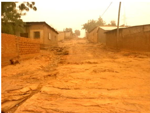
Photo 39 : Ravinement et érosion des fondations à Ouro Kanadi
