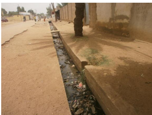
Photo 1 : les déchets obstruent les canaux même au niveau des artères principales (Bibémiré 2)
