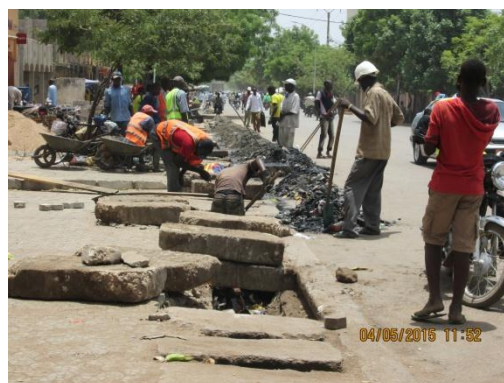
Photo 2 : ... nécessitant une intervention lourde pour les curer
