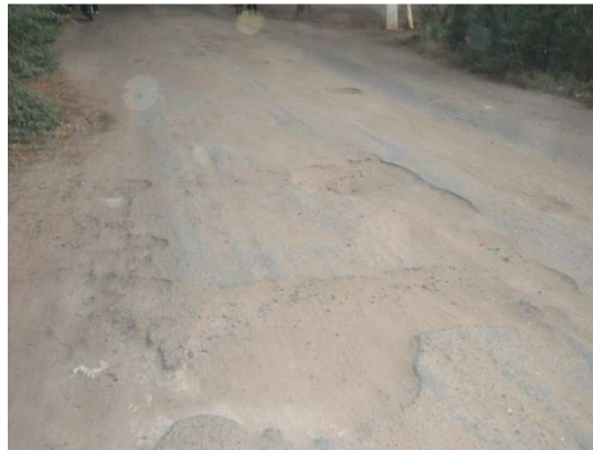
Photo n°10: Voirie secondaire en mauvais état
