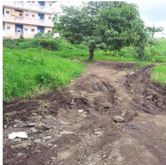
Photo 6 : Voie d'accès existante en très mauvaise état
