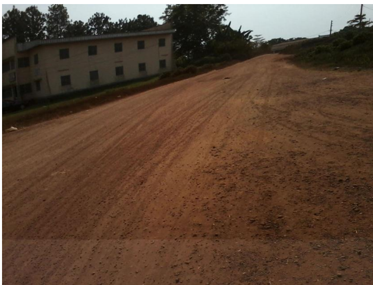
Image N° 21 : Voirie en terre dans la ville de Bertoua
