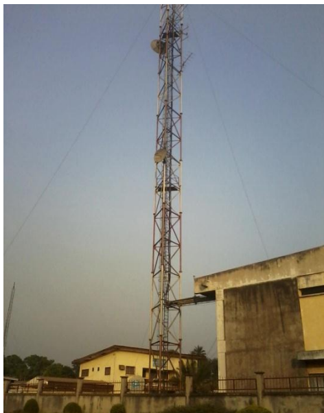
Image N° 27 : Antenne de télécommunication
