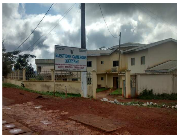
Image N° 22 : Délégation Régionale du Commerce qui compte parmi les édifices publics nécessitant une réfection.
