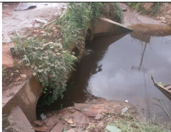
Image N° 7 Ouvrages d'assainissement encombrés par la végétation à Nko'ovos II.
