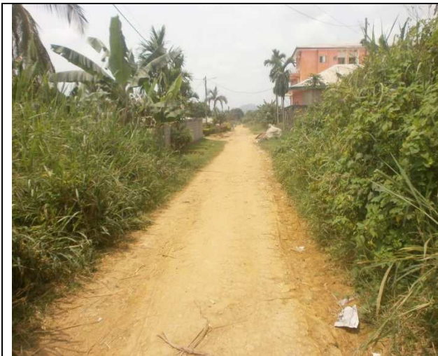
Image N° 3 : voirie Tertiaire non drainée avec végétation.
