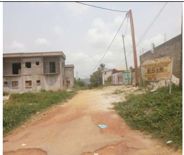
Image N° 4 : Voirie tertiaire non drainée a Angale
