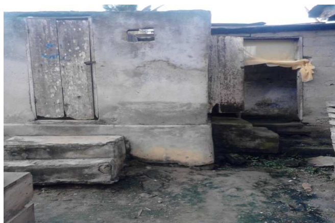
Image N° 46 : Latrine construite sans respect de règles d'art au quartier Mboambé
