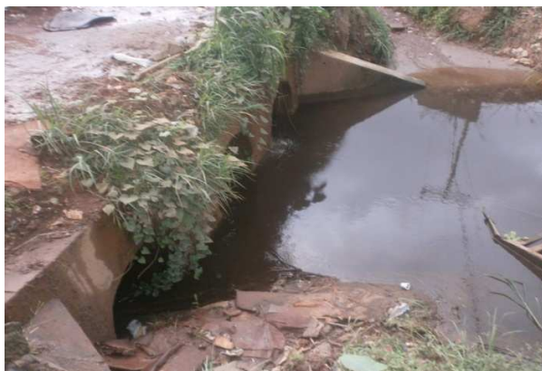
Image N° 62 : Zone encombrées par la végétation et les dépôts d'ordure ménagère et susceptible d'inondation au niveau de la place des fêtes.
