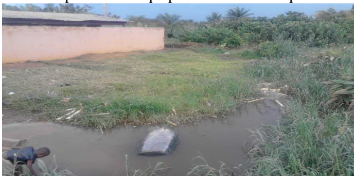
Image N° 49 : La couleur de ce cours d'eau a complètement changé et est devenue plus sombre à cause du déversement des déchets liquides issus de l'abattoir et transportés par son réseau d'assainissement.
