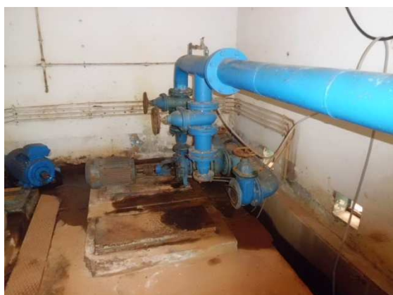
Photo 28: Salle de commandes
