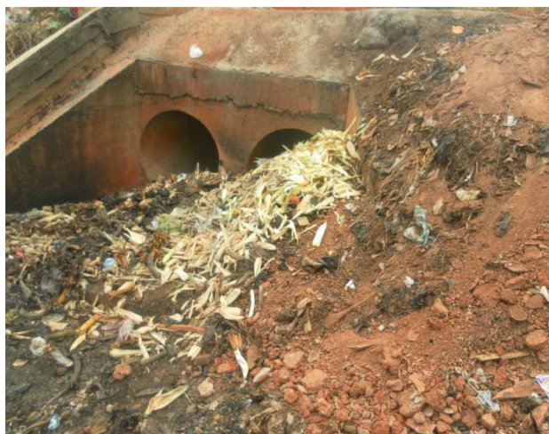
Photo 18 : Buse obstruée par des ordures
