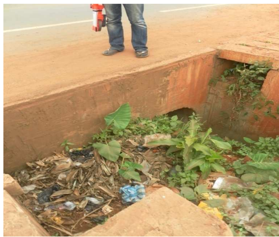
Photo 19 : Caniveau obstruée par les ordures
