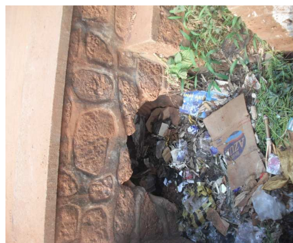
Photo 35 : Bouchage du drain par les ordures
