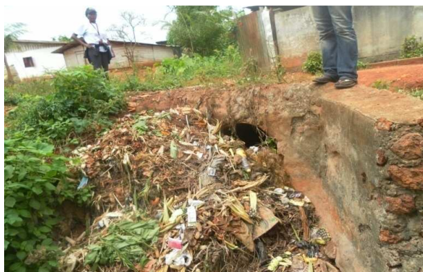
Photo 20 : Buse bouchée par les ordures
