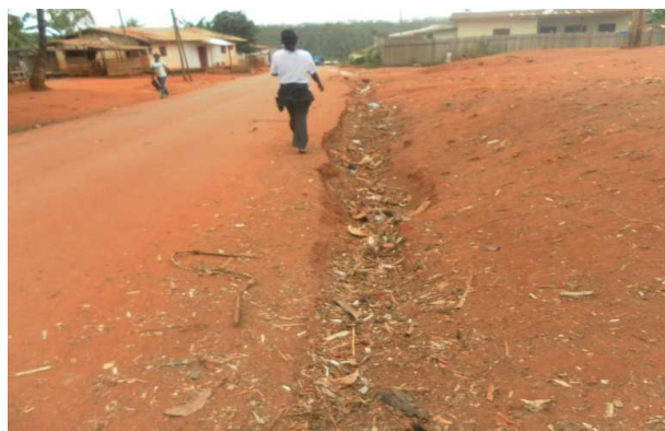
Photo 21 : Route dépourvue de caniveau
