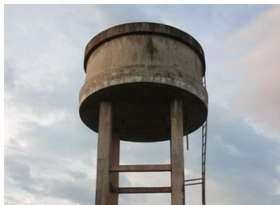
Image N° 9 : Château d'eau pour un établissement scolaire
