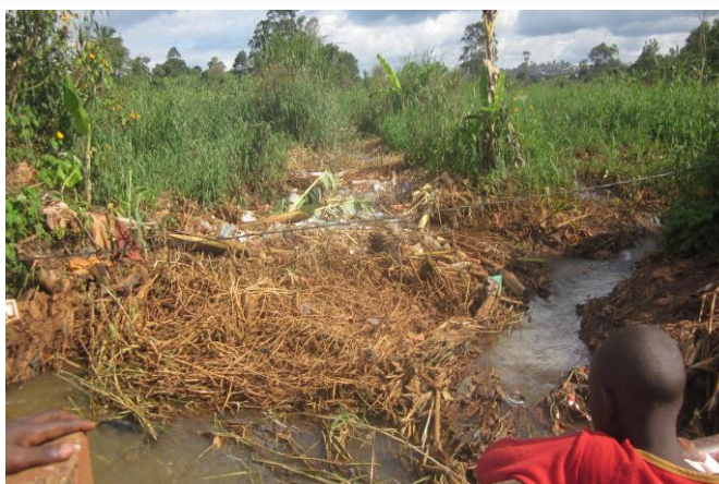
Un drain obstrué à Tyo Village
