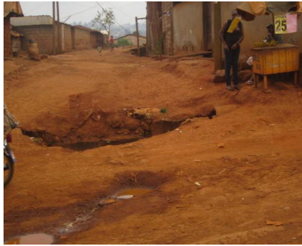
Une buse cassée ou sous dimensionnée au quartier KOUOGOULO
