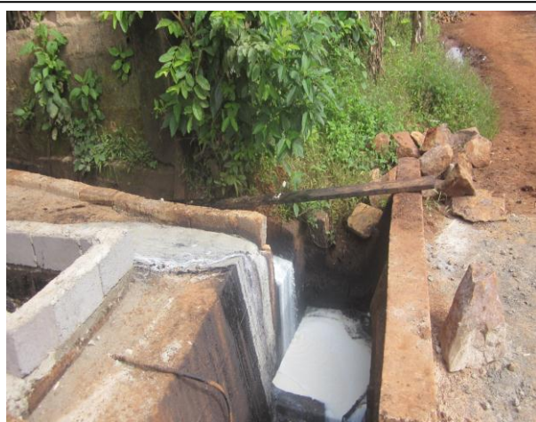
Rejet d'une usine de savonnerie à Kamkop
