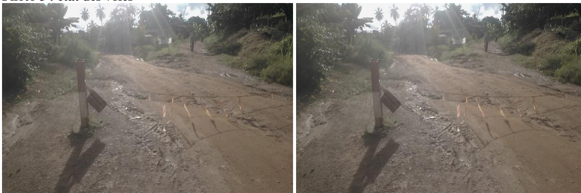
Voirie complètement ravinée
