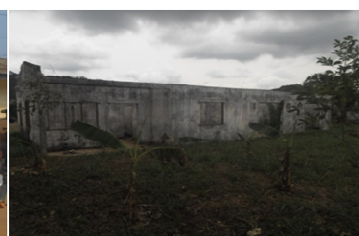
Figure 22 : Bâtiment de la DA/MINADER incendiée (Cliché HTR, 2015)
