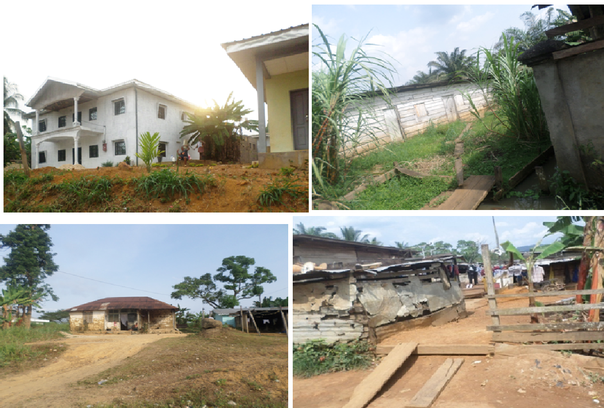
Figure 19 : Etat de dégradation avancée d'habitat de l'époque coloniale terre crue au quartier Briqueterie (Cliché HTR, 2015)
