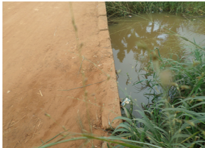
Figure 31 : dalot sous-dimensionné, obstrué par la végétation et causant les inondations sur la voie principale du quartier Tétem (Cliché HTR, 2015)
