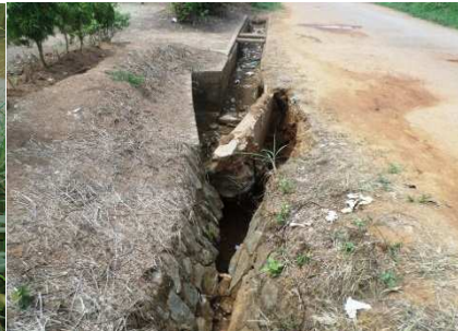
Figure 31 : ouvrage de traversée en, chaussée délabrée (Cliché HTR, 2015)
