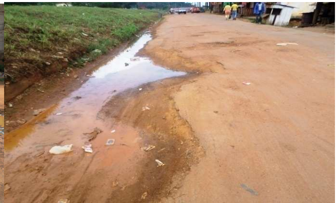
Figure 31 : Forte dégradations sur l'axe R09 et absence des caniveaux (Cliché HTR, 2015)
