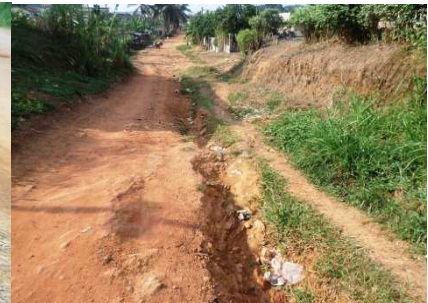
Figure 31 : Fort ravinement de l'axe de la voie dû à l'érosion (Cliché HTR, 2015)
