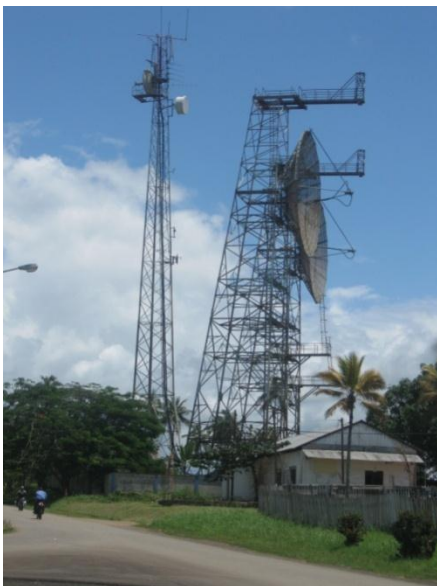
Photo 18 : Station de relais CAMTE
