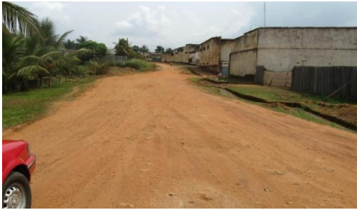
Photo 13 : Carrefour du container – gare routière - carrefour marché centrale ; nids de poule
