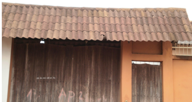
Photo 13: Toiture en tuile flamande vibro-ciment âgée de moins de 2ans (problèmes de stabilité de la couleur et de l'humidité).
