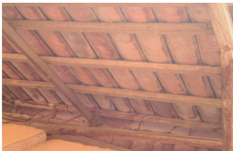
Photo 14: Une vue de l'intérieur de la toiture précédente en tuile flamande âgée de 2ans (problème d'humidité).
