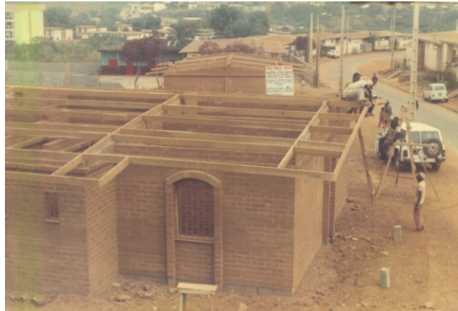
Photo 7: Construction d'une maison témoin au camp SIC (lieu dit Cité Verte) à Yaoundé vers les années 1992.
