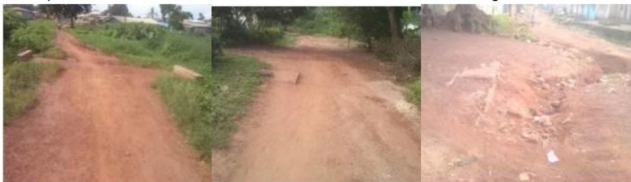
Photo 2: Etat des lieux du tronçon Carrefour Mépo – Carrefour Gbwako (rue 7)
