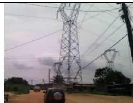
Photo 14: Pylône en acier portant les câbles de haute tension HTB 225
