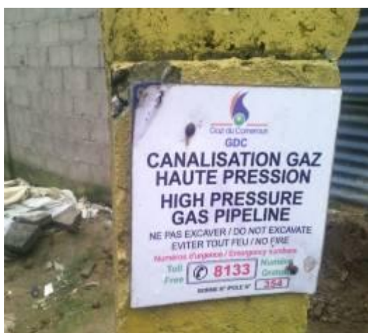
Photo 22: Borne de gaz au marché carrière
