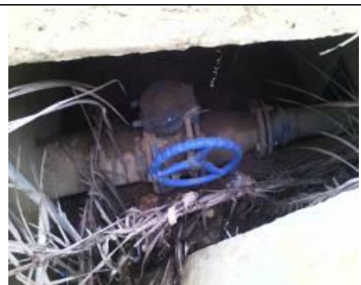
Photo 21: Vanne dans un regard avec réduction de diamètre sur le tronçon Entrée billes –zone MAGZI
