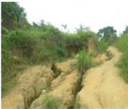
Photo 1: Ravinement sur la chaussée
