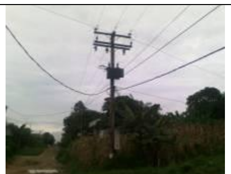
Photo 15: Poteau en bois portant les câbles moyenne tension et un transformateur à déplacer
