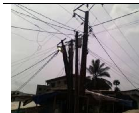
Photo 18: Poteau en bois de CAMTEL portant un coffret de répartiteur
