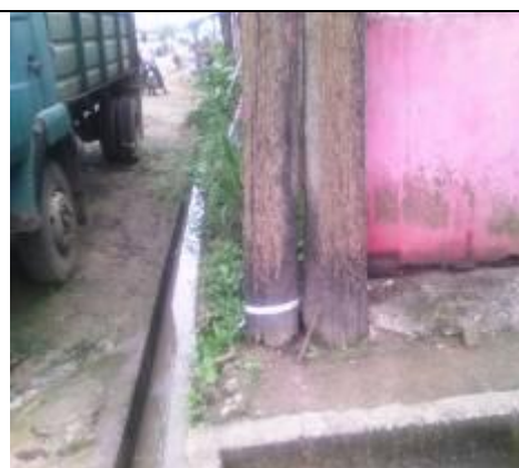
Photo 17: Poteau en bois pourri à la base
