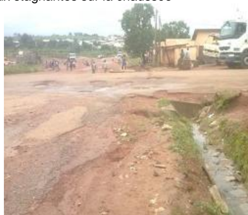
Photo 4: Chaussée revêtue fortement dégradée
