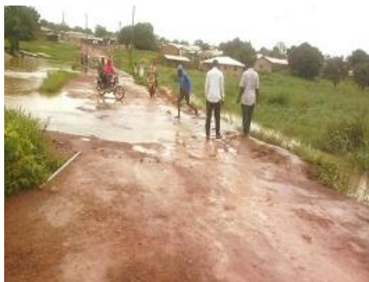
Photo 2: Eaux stagnantes sur la chaussée
