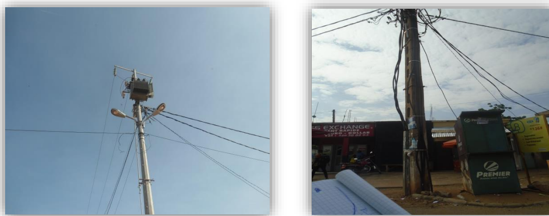
Photo 22: Alimentation en électricité sur le site du projet
