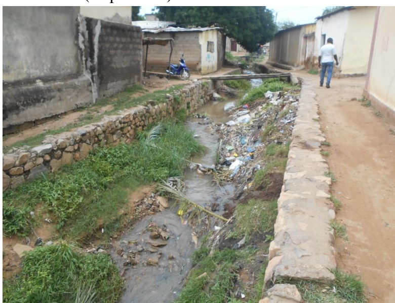
Photo 13 : Un drain mal entretenu
