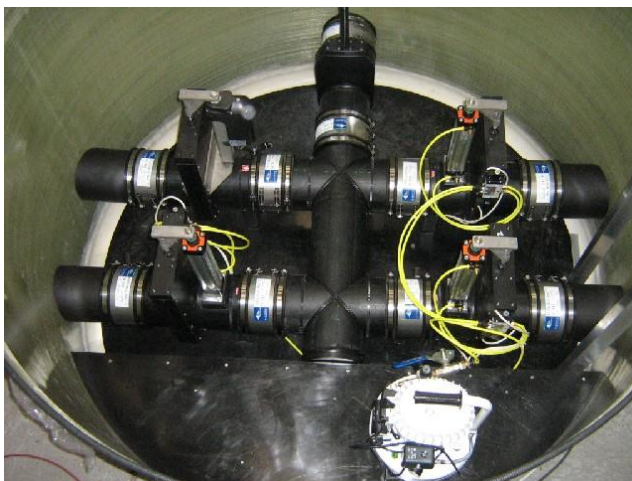
Regard de vannes à pelle automatique
