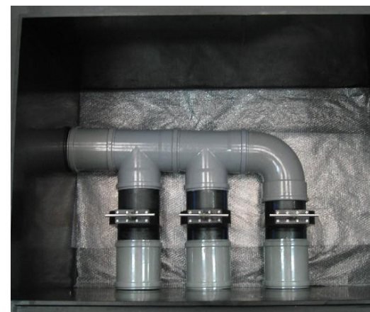
regard de vannes à pelle 200
