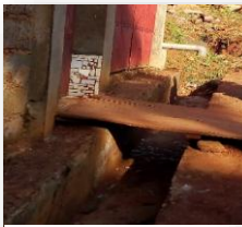
Photo 29: Caniveau privé aménagé
