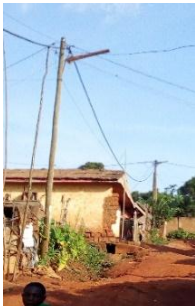
Photo 23: Dispositif rudimentaire d'éclairage public
