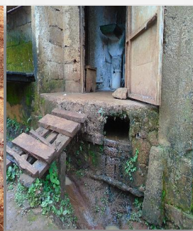
Photo 31: Canal d'évacuation des eaux usées d'un lieu commercial
