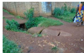
Photo 14: Buse en mauvais état
