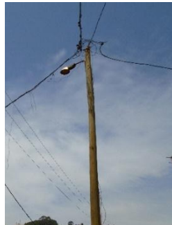
Photo 23: Lampadaire installé sur un poteau électrique
