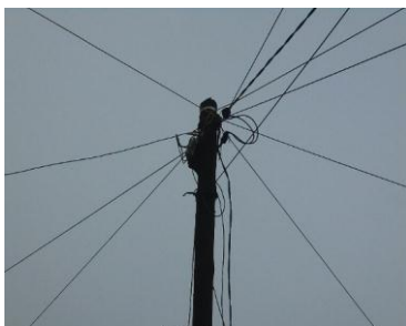
Photo 21: Poteau électrique d'alimentation en énergie électrique
