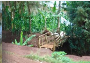
Photo 31: Rigole de ruissèlement sur une voie Primaire
