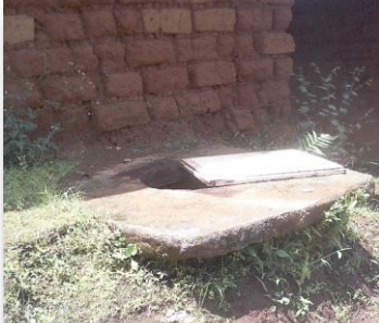
Photo 33: Fosse septique ouverte sur la voie
