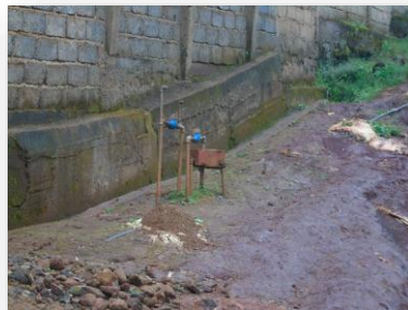
Photo 28: Compteur d'eau sur la voie
