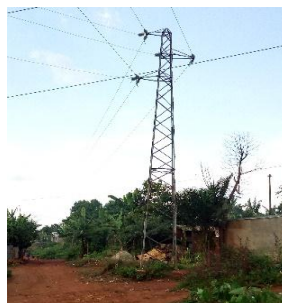
Photo 21: Ligne de moyenne tension traversant le site
