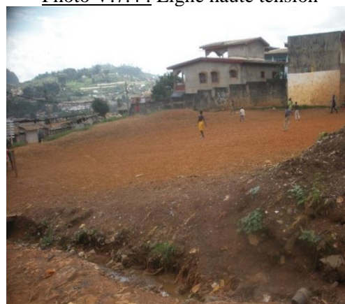
Photo V.7.6 : Présence d'un terrain de football avec un caniveau en terre en mauvais état
