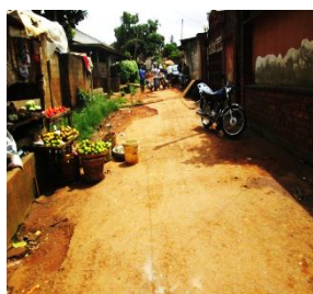
Photo V.5.9 : Voie secondaire bitumée mais en mauvais état
