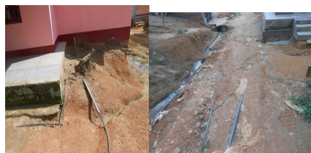
Photo V.9.8 : Tuyaux de la CDE en pleine route et devant un ménage servant à l'approvisionnement en eau.
