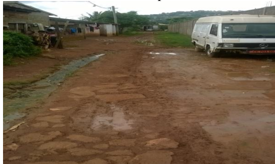
Photo V.3.5 : Circulation de l'eau sur la route du fait de l'absence d'ouvrages d'assainissement
