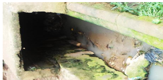
Photo V.6.2 : Caniveau maçonné en très mauvais état
