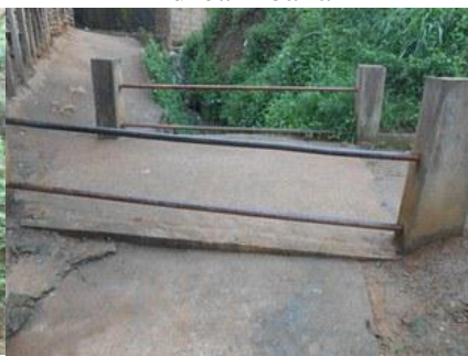
Photo V.10.5 : Unique pont aménagé fait en béton, sur l'unique voie bétonnée de la zone
