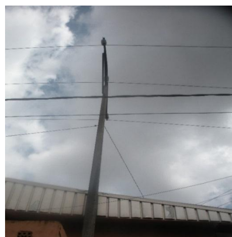
Photo V.7.4 : Ligne haute tension
