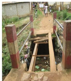
Photo V.5.3 : Platelage d'une passerelle complètement détruite près du point Z4B160
