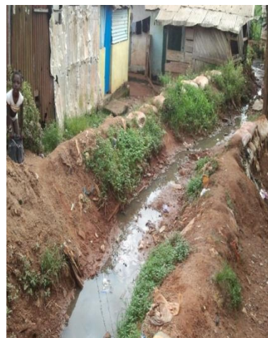
Photo V.4.8 : Drain non aménagé et totalement dégradé
