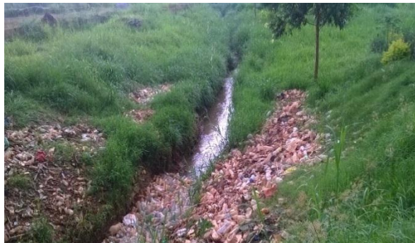
Photo V.3.7 : Drain engorgé par les déchets près du poste de Gendarmerie
