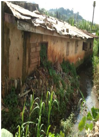
Photo V.4.4 : Maison enfouie dans le sol et serpentée par une eau qui s'est frayé son chemin à cause de l'absence de drain
