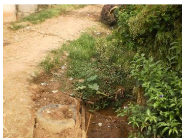
Photo V.8.8 : Fossé non entretenu
