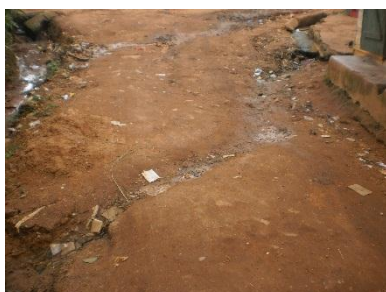
Photo V.8.7 : Dégradation de la chaussée causée par l'absence d'ouvrages d'assainissement des eaux.
