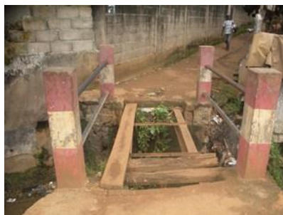
Photo V.10.2 : Pont en acier, dans un état de dégradation avancée, sur lequel on a rajouté une petite planche, traversant le cours d'eau Edzoa Mballa
