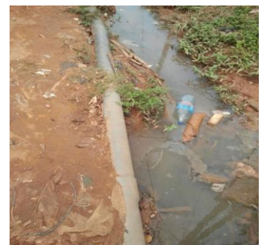
Photo V.4.9 : tuyau d'évacuation des eaux exposé et bordé par une eau usée qui ne s'écoule pas
