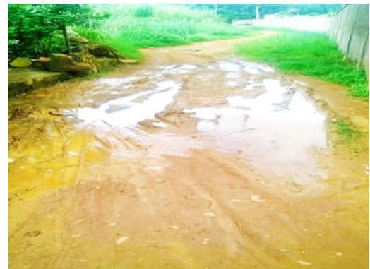
Photo V.3.6 : Stagnation de l'eau sur la chaussée due à l'absence d'ouvrage d'assainissement
