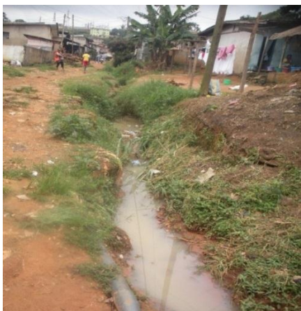
Photo V.7.1 : Caniveau en mauvais état
