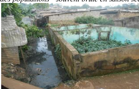
Photo V.9.7 : Maison de code GPS ZB810 abandonnée à cause des montées d'eau pouvant atteindre 2m en période de crue.
